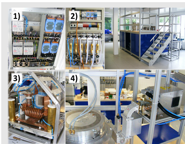
Abb. 6: Komponenten der neuen Anlagentechnik bestehend aus Steuereinschub (1), Gasflusssteuerung (2), Anpassnetzwerk (3) und Mikrowelle (4).
